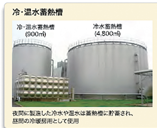
図表4-2 冷・温水蓄熱槽
