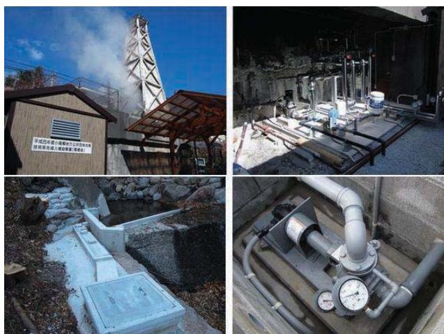
図4. 18 東伊豆町が運営する温泉発電所の外観(左上)と配管(右上)、小水力発電の取水口(左下)と発電機(右下) 12) (出典：東伊豆町企画政策課)
