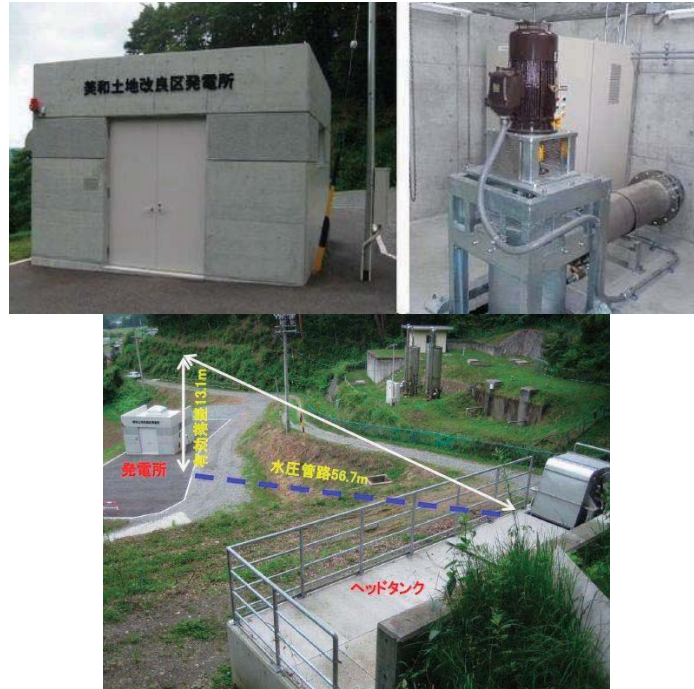
図4. 10 「美和小水力発電所」の建屋と水車発電機（上）、小水力発電の仕組み（下） 4) （出典：長野県農政部）
