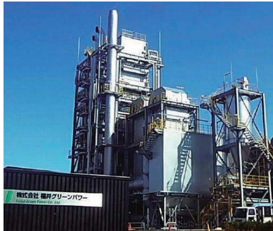
図4. 7 「大野発電所」の全景 3) (出典：福井グリーンパワー)
