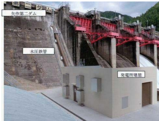
図4.14 「新串原水力発電所」の小水力発電設備 11) (出典：中部電力)
