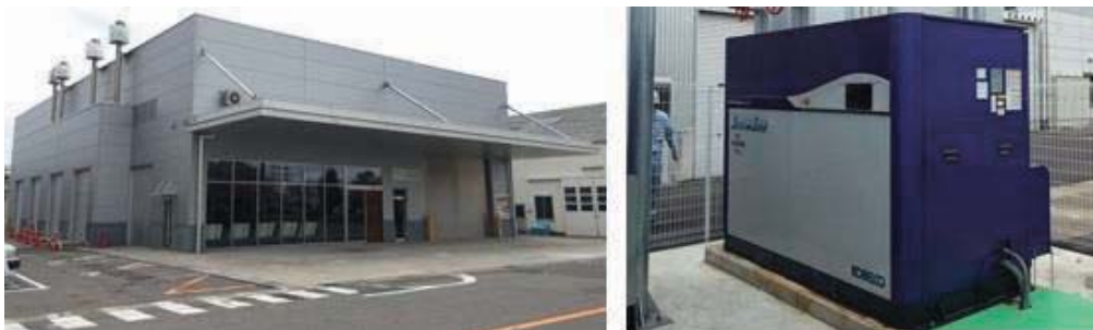
図4. 5 木質バイオマス発電の建屋と発電機 10) (出典：コマツ)
