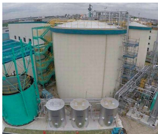
図4. 22 「横根バイオガス発電施設」の全景 7) (出典：オオブユニティ)
