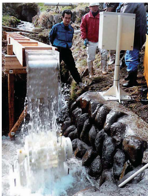
図 8. 11 開放型貫流水車の運転の様子
