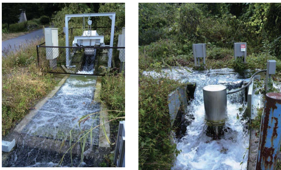
図 8. 13 水車への塵芥閉塞による水路からの溢流
