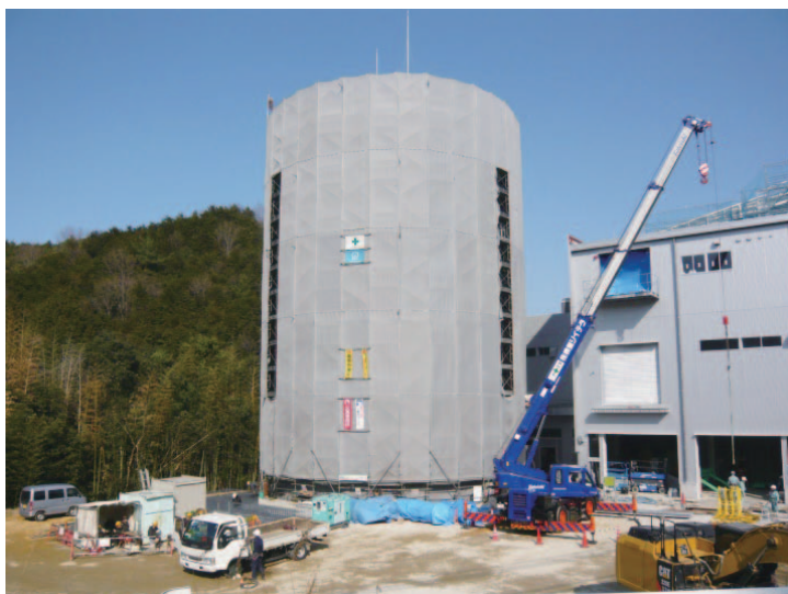
図 2. 5. 6 メタン発酵槽①（全景）
