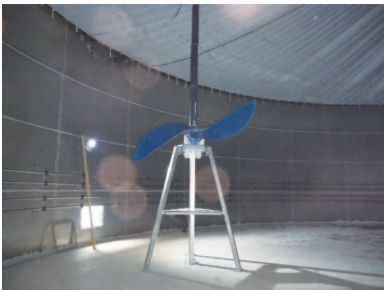
図2.2.3 メタン発酵槽内部
