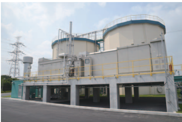
図2.3.6 バイオガス発電機
