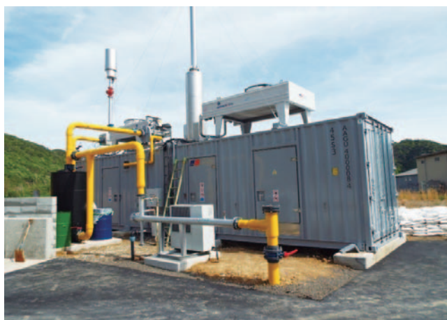
図 2. 2. 9 CHP ユニット／ガスコンディショニングユニット
