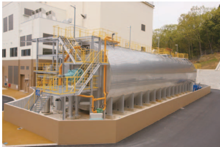
図 2. 4. 3 メタン発酵槽 (出典：南但広域行政事務組合)
