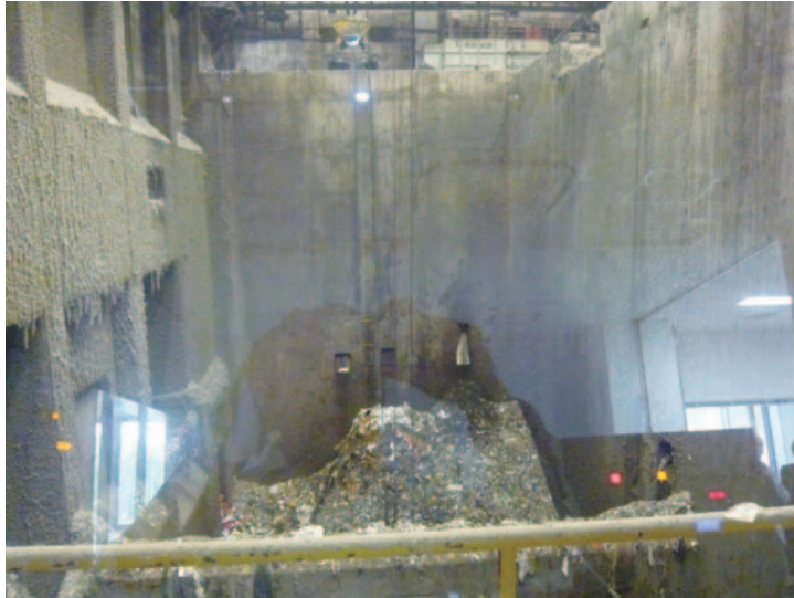
図2.4.7 ごみピット、ごみクレーン
