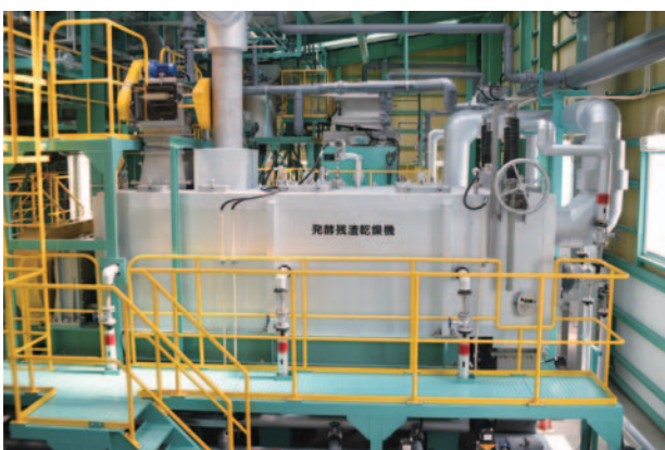
図2.3.8 汚泥乾燥設備
