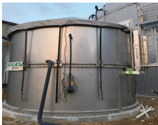
図 2. 2. 5 消化液貯蔵槽
