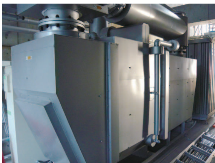
図 2.5.9 廃ガス蒸気ボイラー
