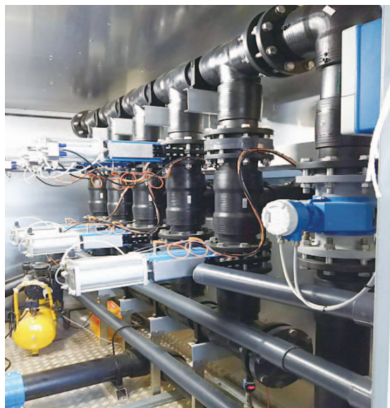
図 2. 2. 6 ポンプユニット
