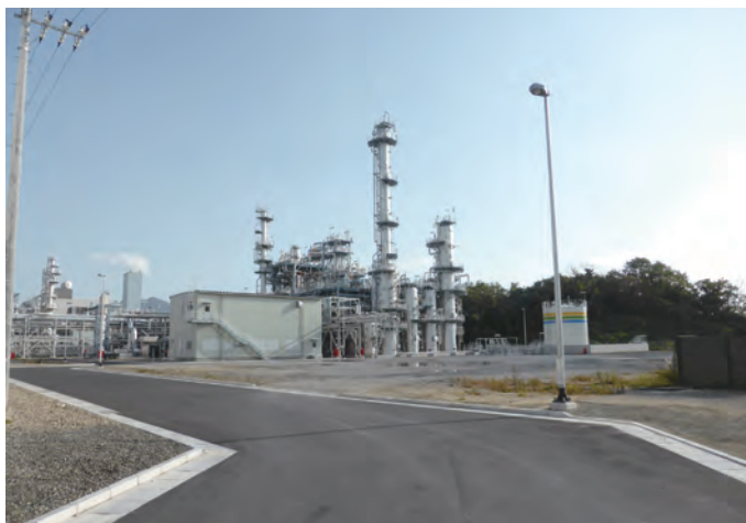
図表 2-10 プラント写真②<CO 2 分離・回収設備>
