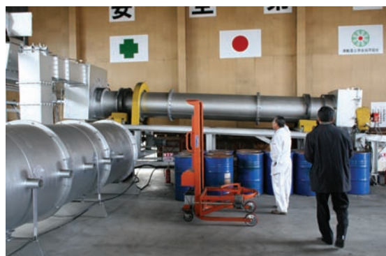
写真一19 体育館内に設置された連続炭化炉
