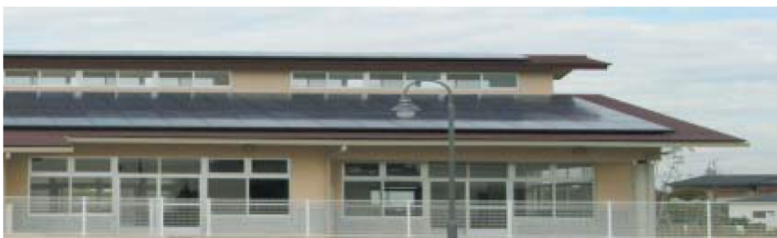
愛知県刈谷市 知的障害者授産施設：太陽光発電設備（定格出力20kw/平成15年7月運開）
