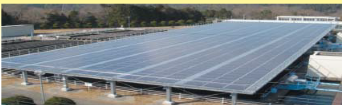
三重県一志郡 高野浄水場：太陽光発電設備（定格出力150kw/平成16年3月運開）
