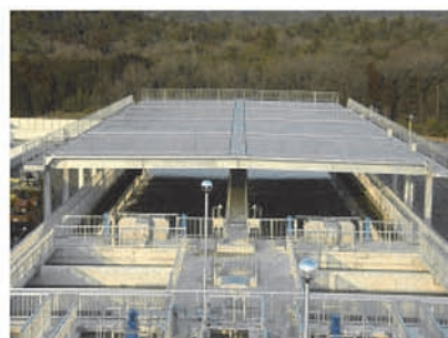
ゆめが丘浄水場（三重県伊賀市）
