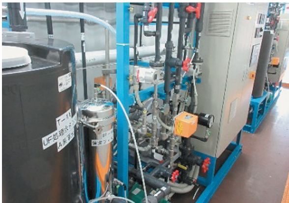
「ウォータープラザ北九州」内に設けた新たな試験プラントとその内部
