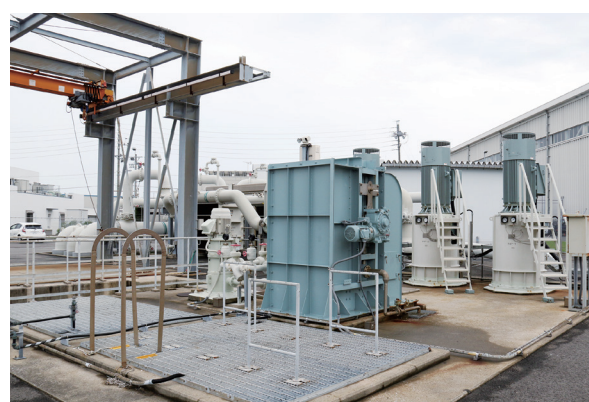
図表6-1 海水利用設備
