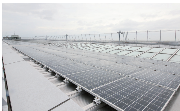
図表5-1 第1ターミナルビルのセンターピア屋上に設置された太陽光発電パネル
