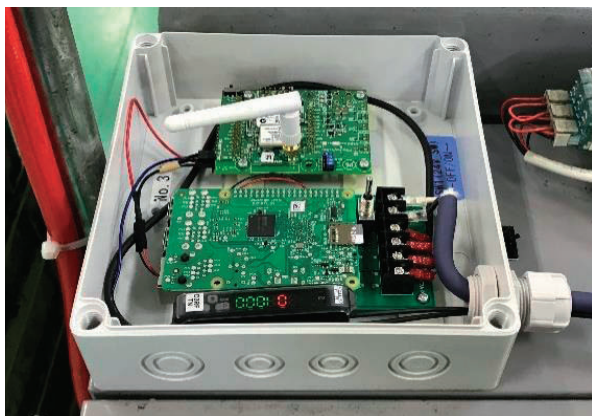
図17 工場内設備に設置されたデータ送信部
