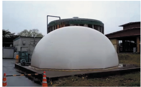
図11. ガスホルダー（バイオガス貯留タンク）
