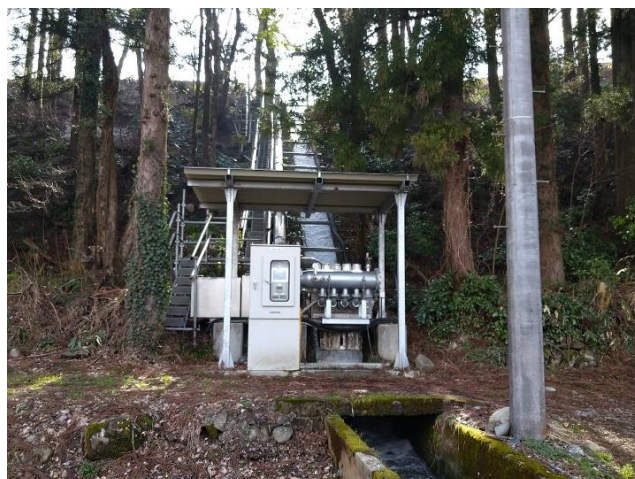
図 5-26. 水力発電施設
