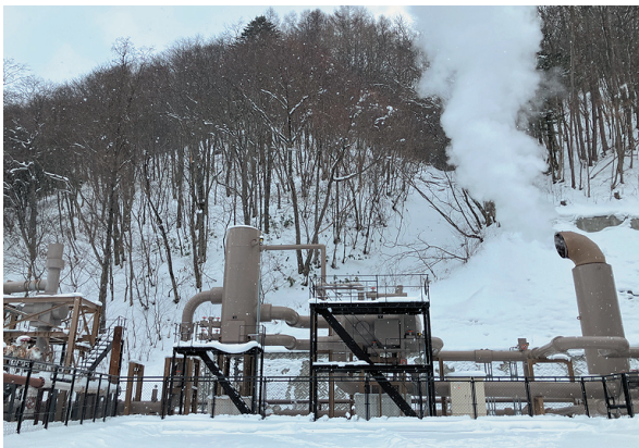
図5 蒸気生産エリア 中央左の塔で熱水を分離し街に送る
