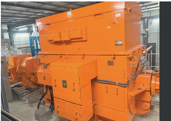
図7 オレンジ色に塗られた発電機
