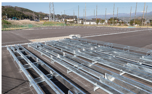
図8 エス・バードに設置された大型リアクター用架台
